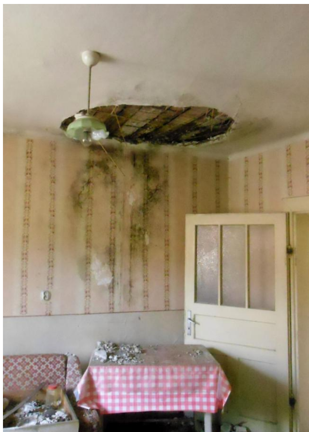
Miestnosť č. 1.02 – stav pred rekonštrukciou s poškodeným stropom a bočnými stenami.
