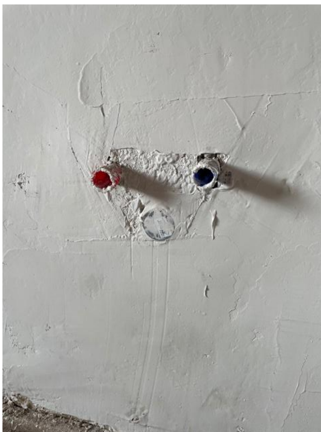
Vyústenie rozvodov vody pre budúce osadenie nového vykurovacieho kotla.
