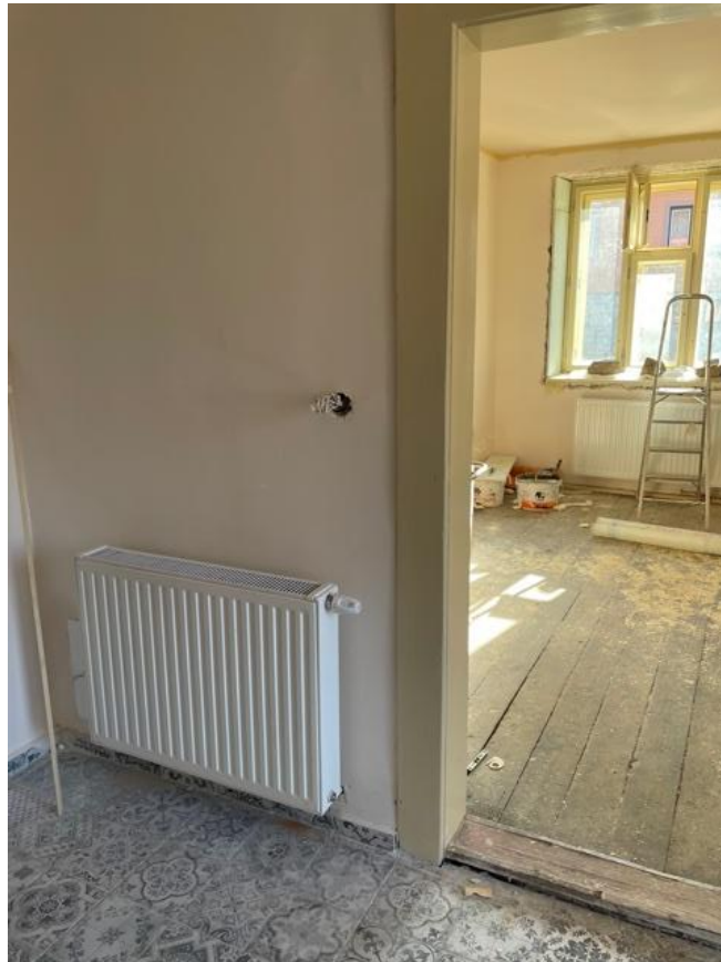
Nové rozvody kúrenia s osadeným radiátorom v chodbe.
