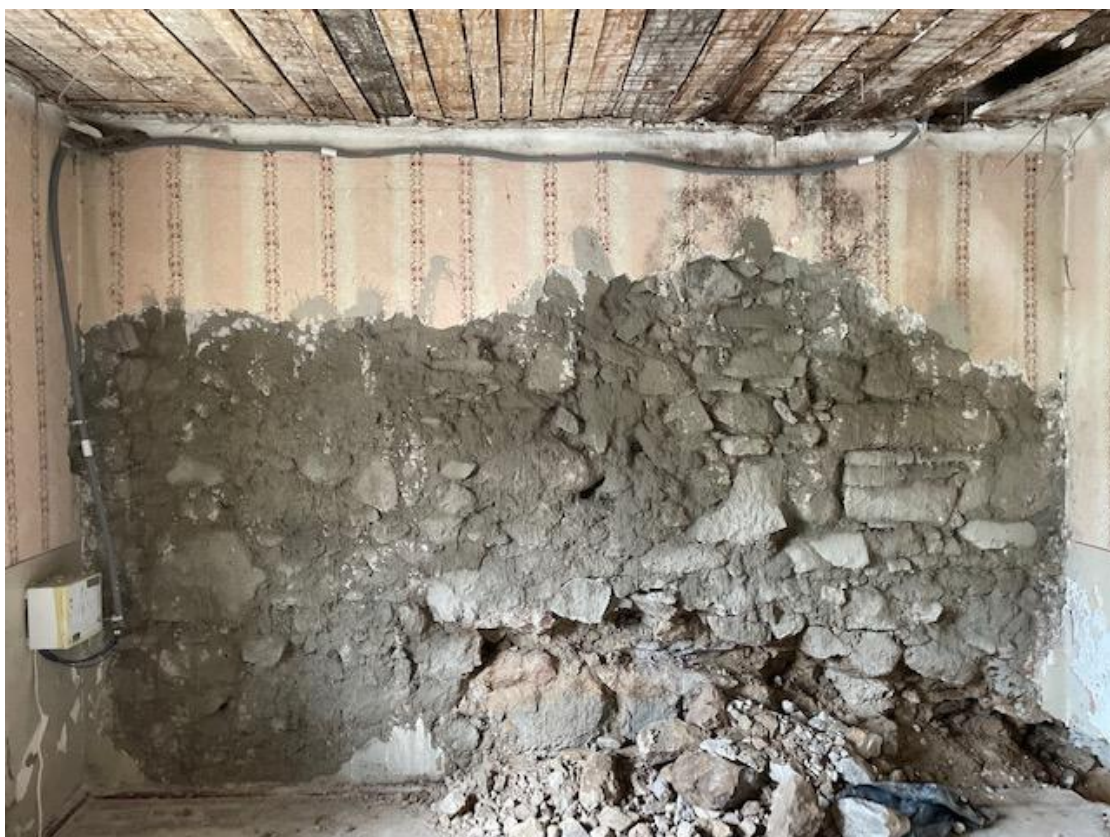
Miestnosť č. 1.02 – steny po čiastočnom odstránení poškodených omietkových vrstiev.
